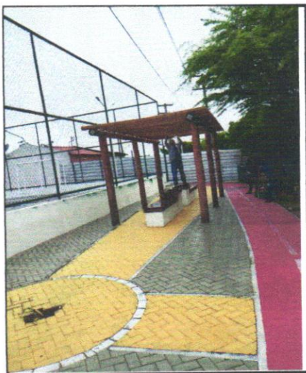
FOTO - 17 - Assentamento de peças de eucalipto tratado, d=19 a 22cm para confecção de pergolado (ref:obra Sergipetec)
